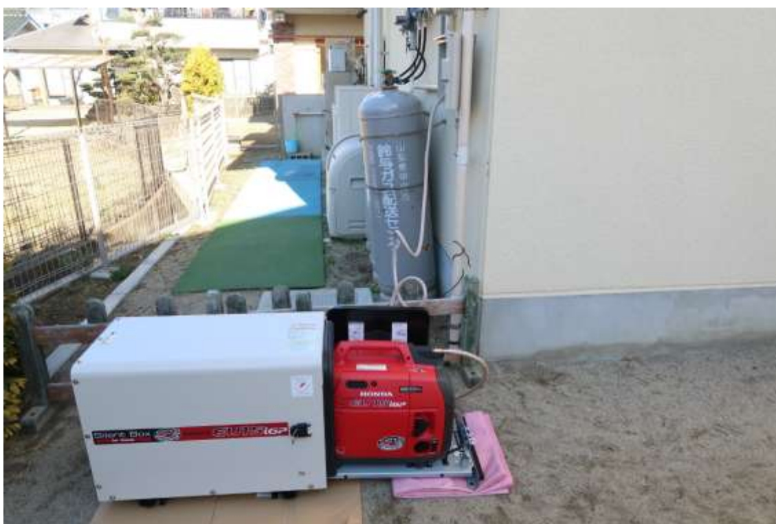
LPG 発電機と消音ボックス
